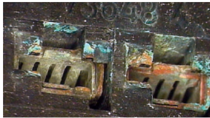
Nem ve korozyon izleri olan kavrama
