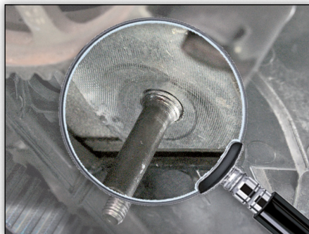
Figur 1: Støtteboltens er ikke skruet korrekt.
